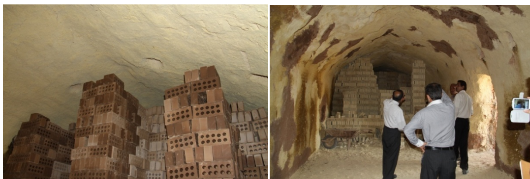
شکل ۴-۶: تصویر یکی از قمیرهای کوره‌های هوفمن کارخانه شیرین سفال (راست) و سوراخ‌های تعبیه شده روی سقف آن برای مشعل‌ها (چپ)
