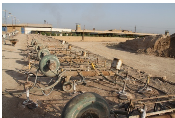
شکل ۴-۷: نمایی از سقف کوره هوفمن کارخانه شیرین سفال (بالا) و سیستم دهش هوا و گاز و مشعل‌ها قرار گرفته روی سوراخ‌های موجود در سقف (پایین)
